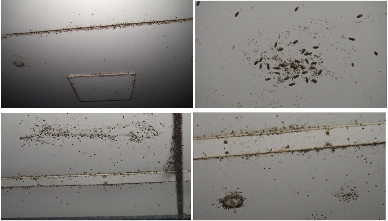
À l'INRA, des mouches prolifèrent sur les murs et les plafonds
